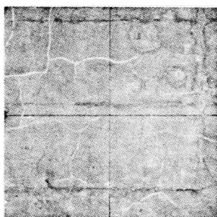
写真-5 2方向のひびわれ。
