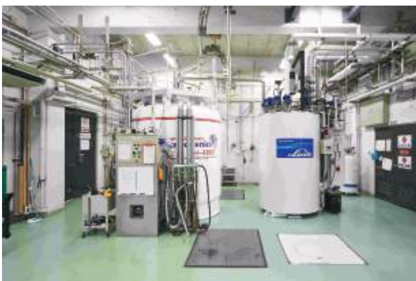
2018 年に吹田分室に設置された Linde 社製 L140 型ヘリウム液化装置.
