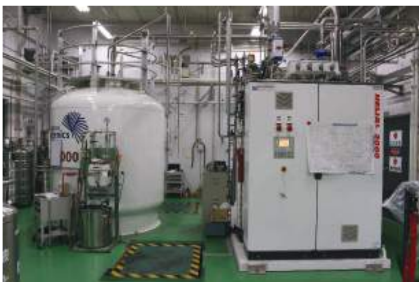
2005 年に吹田分室に設置された Air Liquid 社製 HELIAL2000 ヘリウム液化装置.
