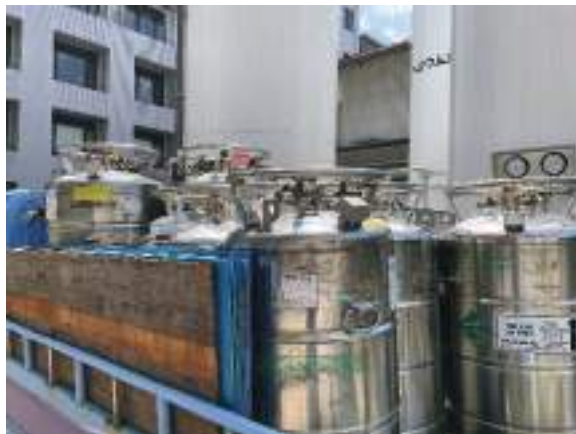
ヘリウム液化事業で業者がトラックで運び込んだヘリウムベッセル。
