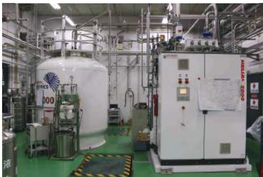
百瀬先生が設置に携わった吹田分室のヘリウム液化装置.
