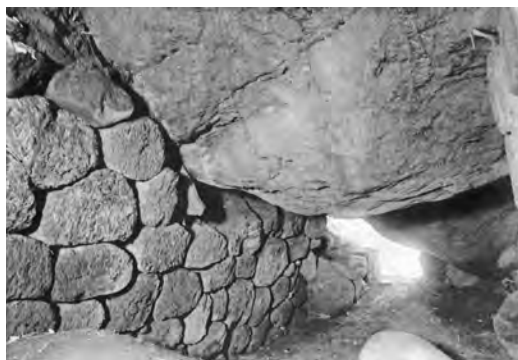
図6 総社二子山古墳後円部の崩壊した石室
