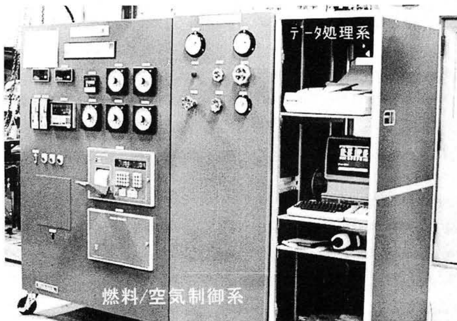
図 2.2.5 スワールバーナ燃焼実験に使用した燃焼負荷制御装置
