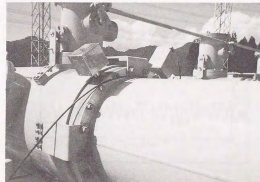
図 3.16 高周波電圧測定器
