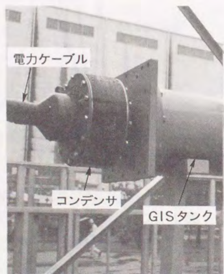
図7.9 ケーブルヘッド部
