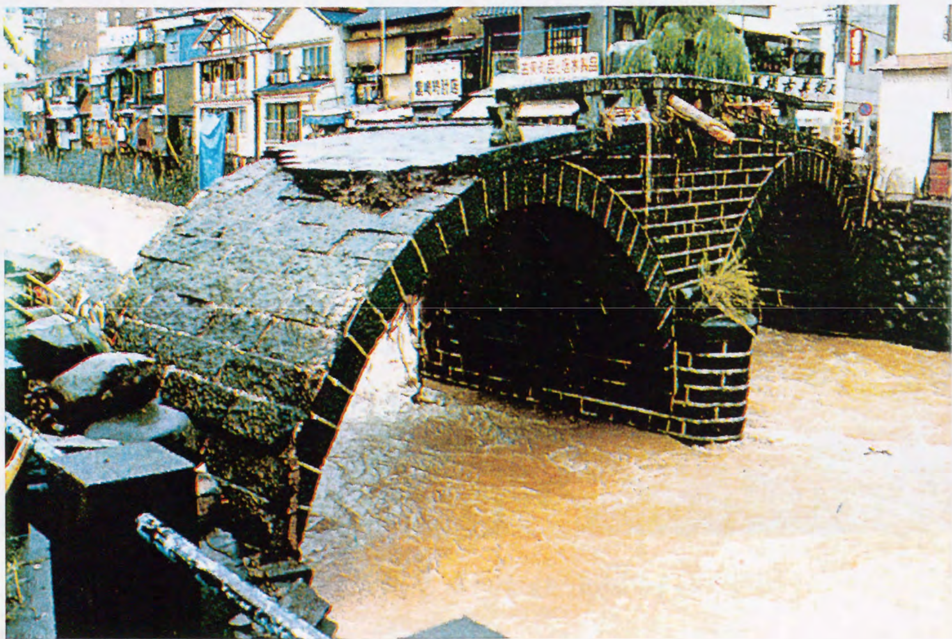
写真Ⅵ-2 損壊した重要文化財眼鏡橋(長崎市総務部・教育委員会(1992)より)
