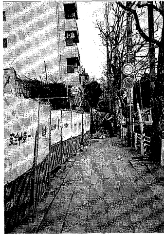
図7.7 閉塞した歩道 (灘区, 1月21日)
