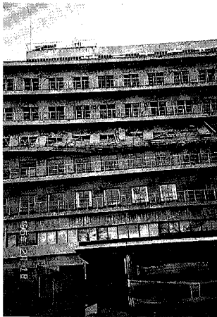
図 0.11 公立病院の被害の様子 (5階部分が押しつぶされる形で全壊した神戸市立西市民病院)
