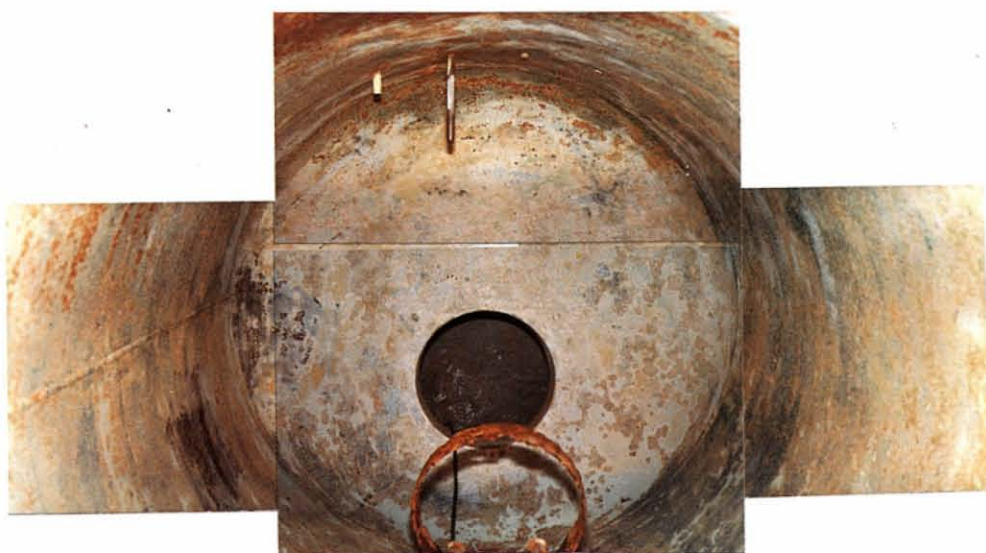
図 6.1 1 タンク内面におけるアルミニウム溶射皮膜の状態 (稼動1年後)
