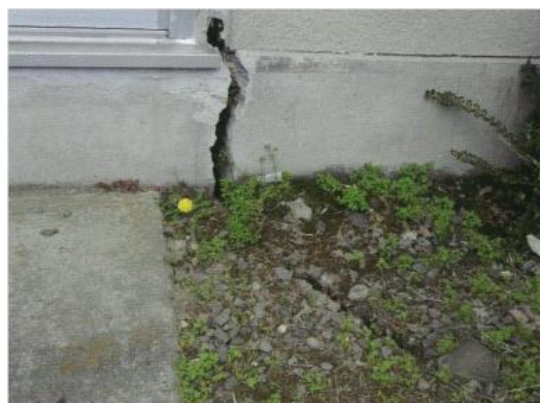
d) 地割れによる建物基礎の被害
