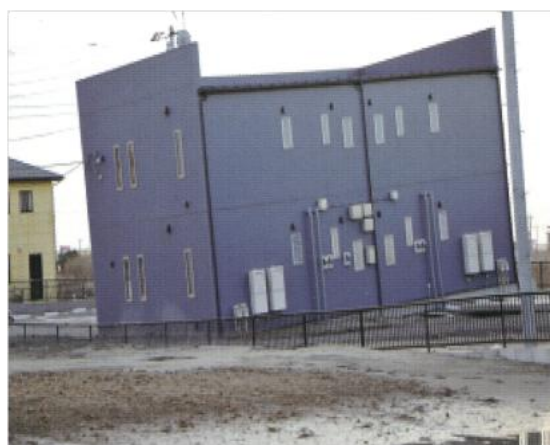
b) 傾斜した直接基礎建物
