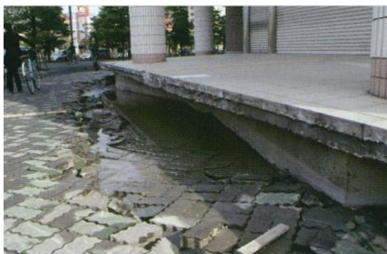
c) 建物基礎周辺の地盤沈下
