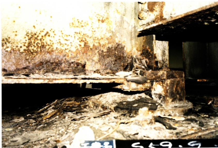
写真-1.1 腐食による断面欠損
