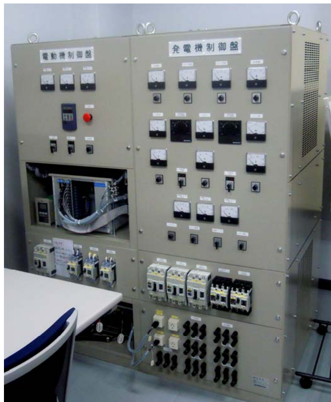
図 6.11 導入された発電システムの配電盤
