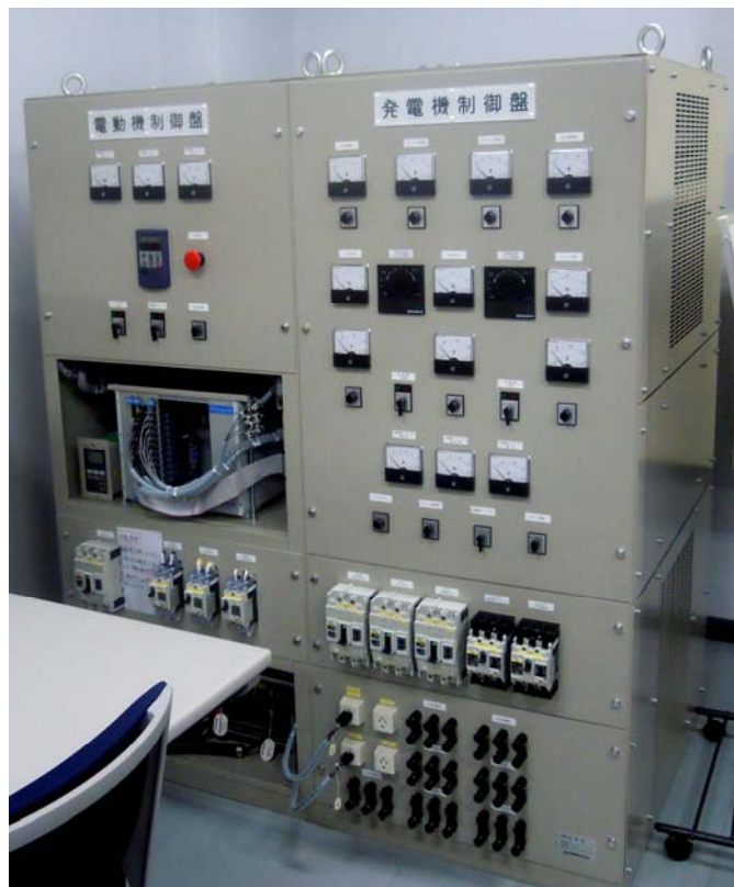
図 6.11 導入された発電システムの配電盤
