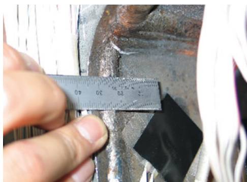
写真-2.2.4 フランジ交差部端部の溶接 ビード割れ (試験体 2, -3δ y )
