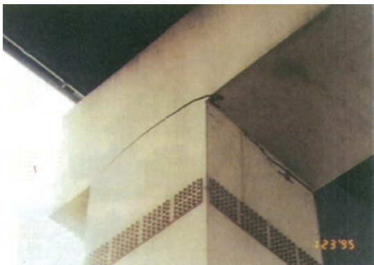
写真-1.1.5 隅角部の溶接割れ 1.1)
