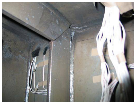
写真-2.2.2 補剛材の溶接割れ (試験体 4, +3\delta_y )
