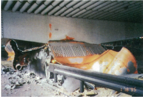
写真-1.1.1 鋼製橋脚の倒壊 1.1)
