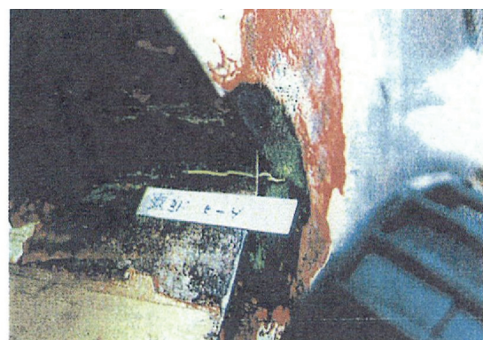
写真-1.1.6 隅角部の疲労き裂 1.4)
