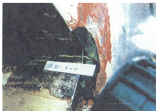
写真-1.1.6 隅角部の疲労き裂 1.4)
