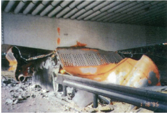
写真-1.1.1 鋼製橋脚の倒壊 1.1)
