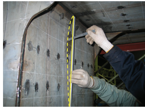
(b) 柱内側フランジの面外座屈 （試験体4，終了後）
