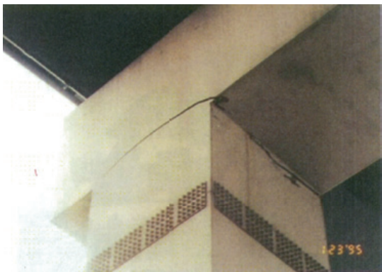
写真-1.1.5 隅角部の溶接割れ 1.1)
