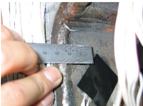
写真-2.2.4 フランジ交差部端部の溶接 ビード割れ (試験体 2, -3\delta_y )
