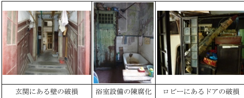
写真 3-2 老洋房の共用部分の老朽化等の状況
