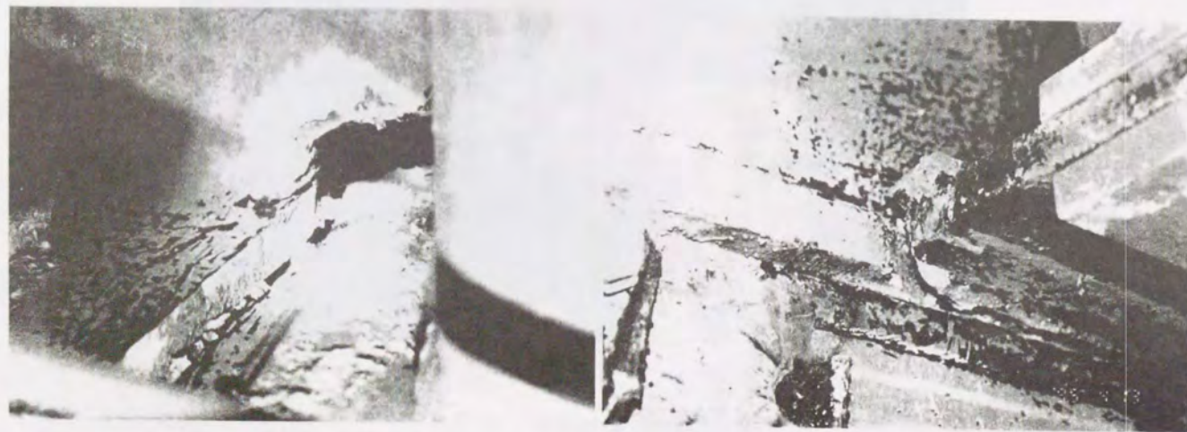
図1.2.9 スカラップ底部から発生した脆性き裂の例 (Type b)
