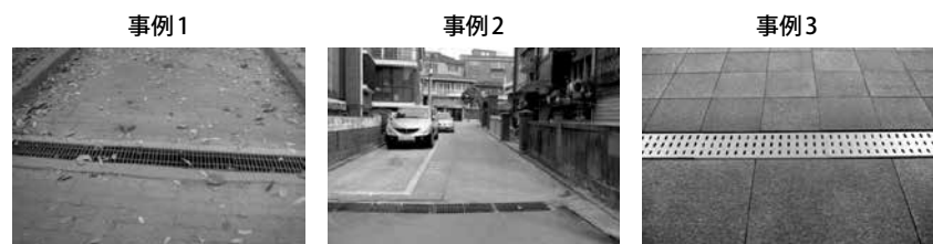
事例1 自転公園内での路面の蓋の隙間が歩行方向で長い模様であり、車いすの車輪が陥る恐れがある。（ノウォン区）
