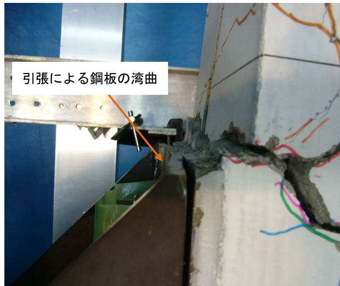
(a) 引張側デバイスの損傷
