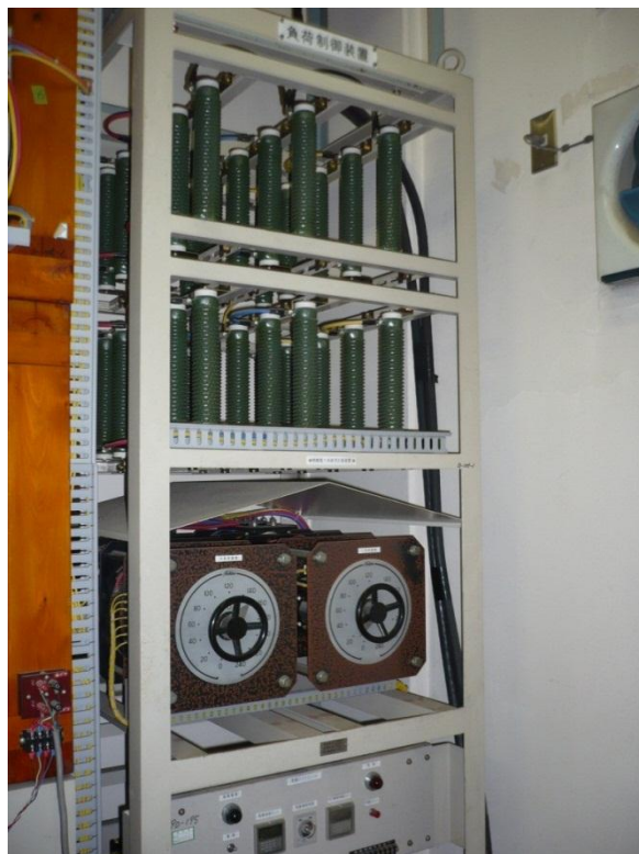
図 7-4 負荷制御装置
