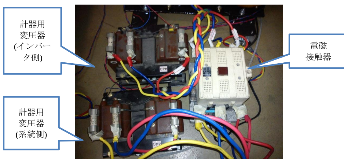
図 5-4 電磁接触器と計器用トランス
