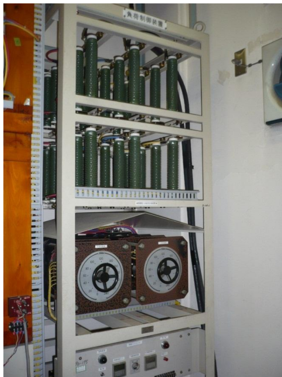
図 7-4 負荷制御装置
