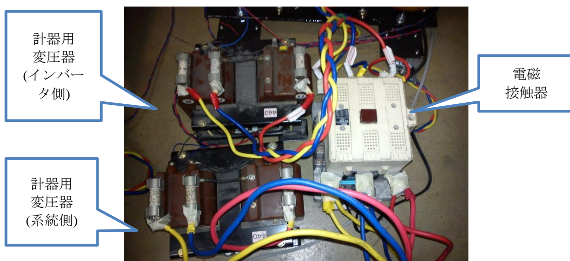
図 5-4 電磁接触器と計器用トランス
