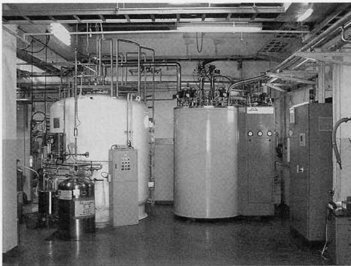
図1 Linde 社製 TCF50ヘリウム液化装置（右手）と4000ℓの液体ヘリウム貯槽
