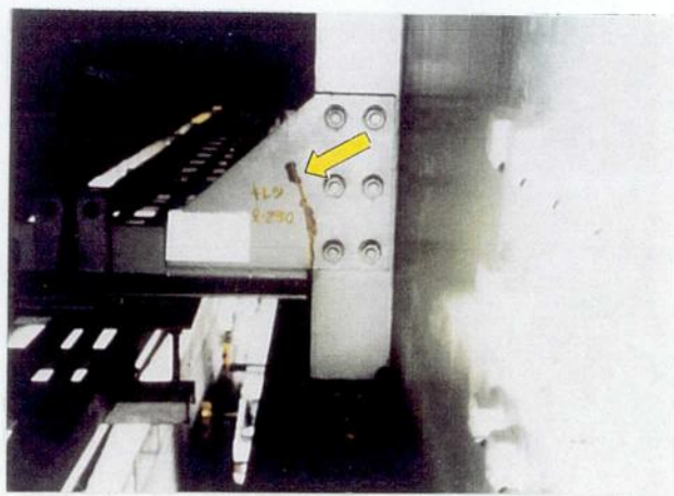
写真－3. 2. 6 対傾構ガセットの亀裂
