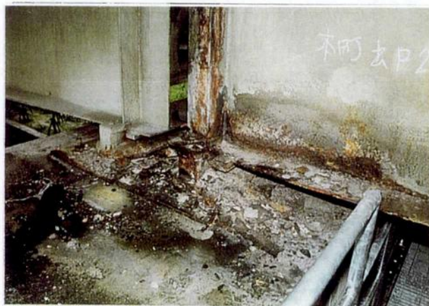
(a) 損傷状況
