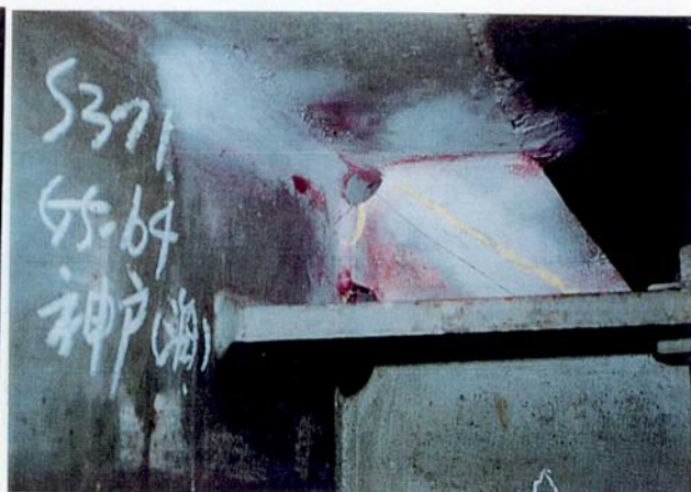
写真－3. 3. 3 タイプ2の損傷
