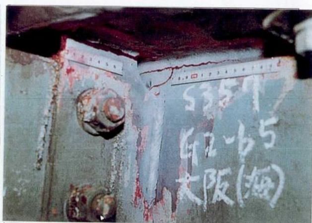
写真－3. 3. 5 タイプ4の損傷
