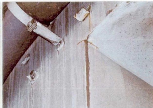
写真－３．２．１０ 鋼製Ｔ型橋脚隅角部の亀裂
