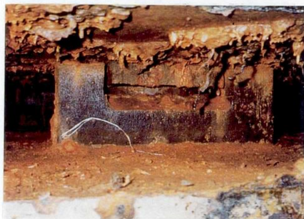
写真－3. 2. 1 鋳鋼製支承の腐食
