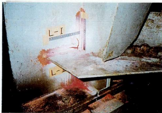
写真－5.2.1 桁端部横構 取付けガセット近傍の損傷状況
