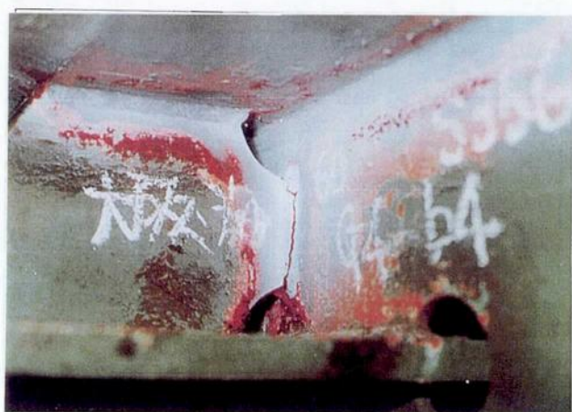
写真－3. 3. 4 タイプ3の損傷
