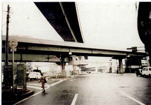
(a) 腐食損傷橋梁
