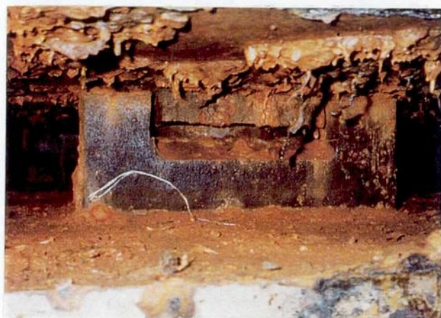
写真－3. 2. 1 鋳鋼製支承の腐食
