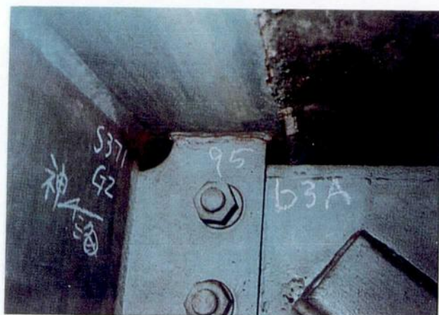
写真－3. 3. 2 タイプ1の損傷
