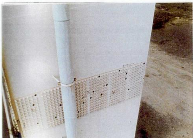
写真－３．２．１１ 高力ボルトの遅れ破壊
