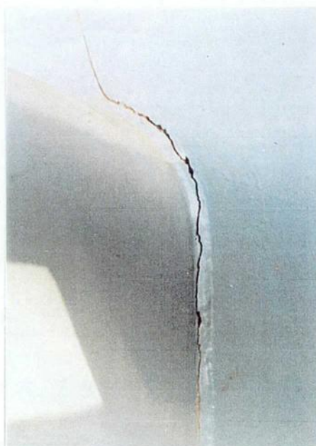
写真－3. 2. 4 鋼桁腹板切欠き部の亀裂
