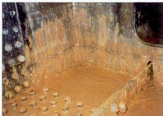
写真－3. 2. 3 鋼製フーチングの腐食
