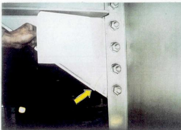
写真－３．２．７ 端横桁ニーブレース下端部の亀裂
