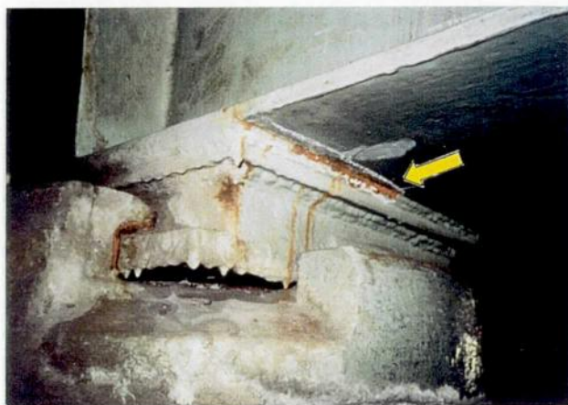
写真－３．２．９ ソールプレート溶接部の亀裂
