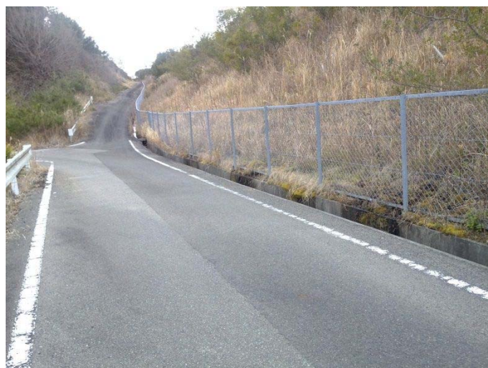
写真-4.2.3 対象盛土 湧水(遠景)
