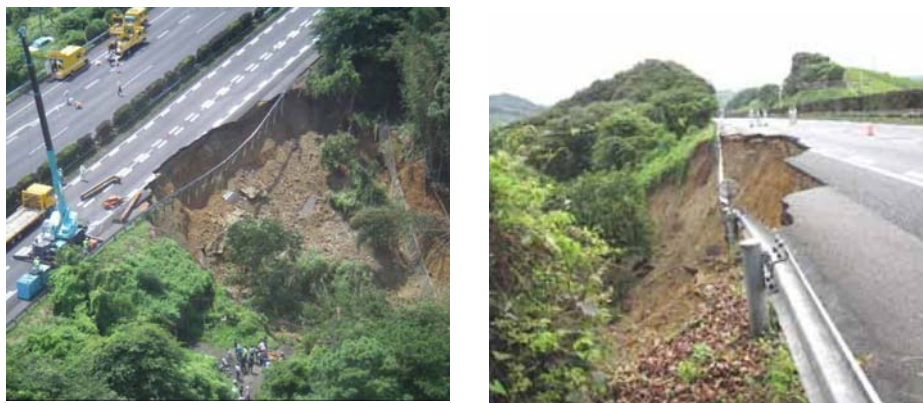
写真-1.1.1 2009 年駿河湾を震源とする地震により被災した東名高速 （出典：中日本高速道路(株)）
