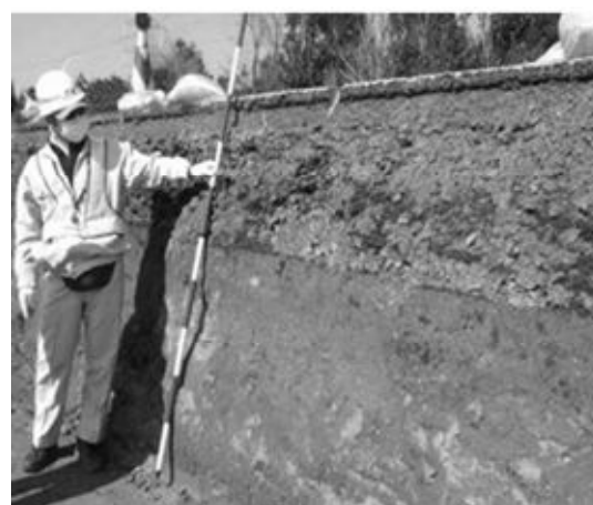
写真-2.2.2 対象盛土の天端変位量 22)
