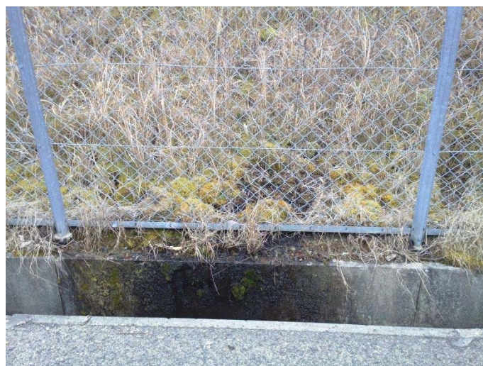
写真-4.2.4 対象盛土 湧水(近景)
