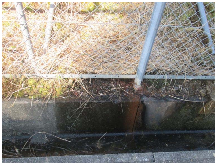
写真-4.4.1 湧水発生箇所
