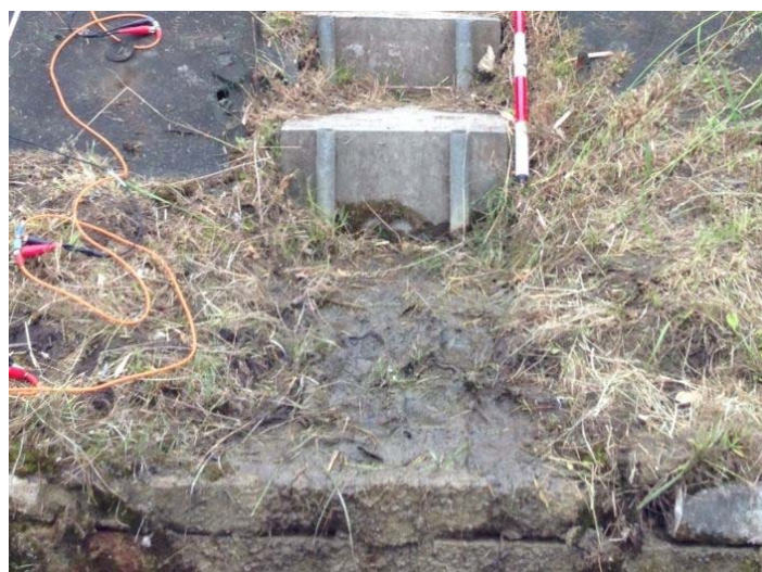
写真-3.3.1 湧水発生箇所
