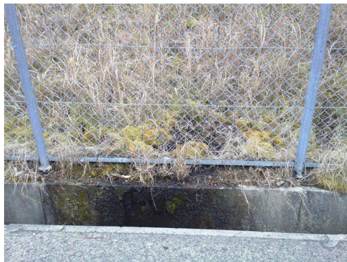
写真-4.2.4 対象盛土 湧水(近景)
