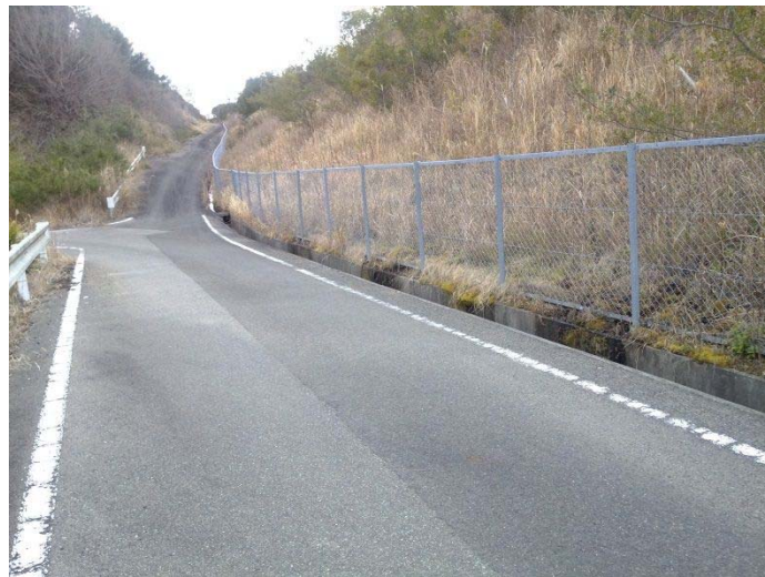
写真-4.2.3 対象盛土 湧水(遠景)
