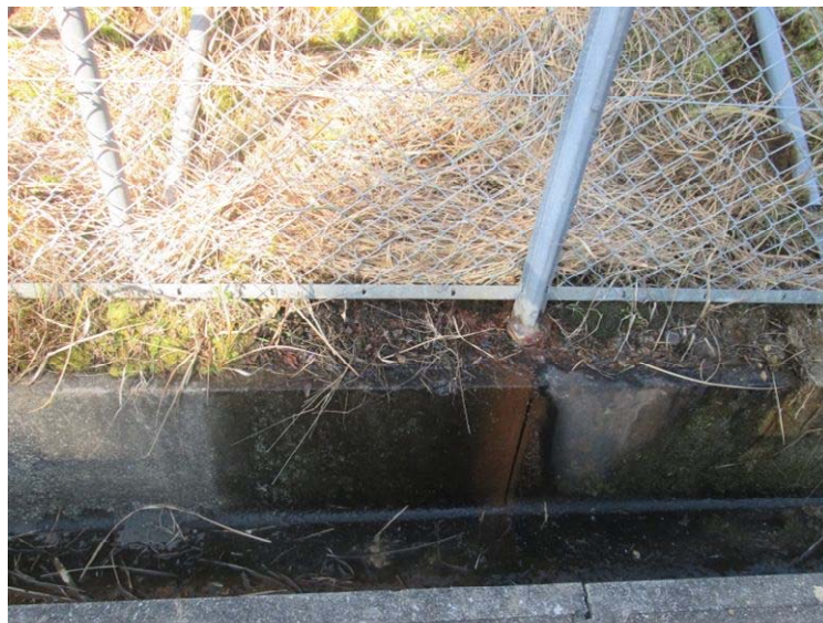
写真-4.4.1 湧水発生箇所
