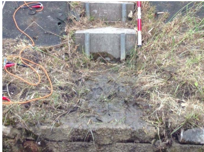
写真-3.3.1 湧水発生箇所
