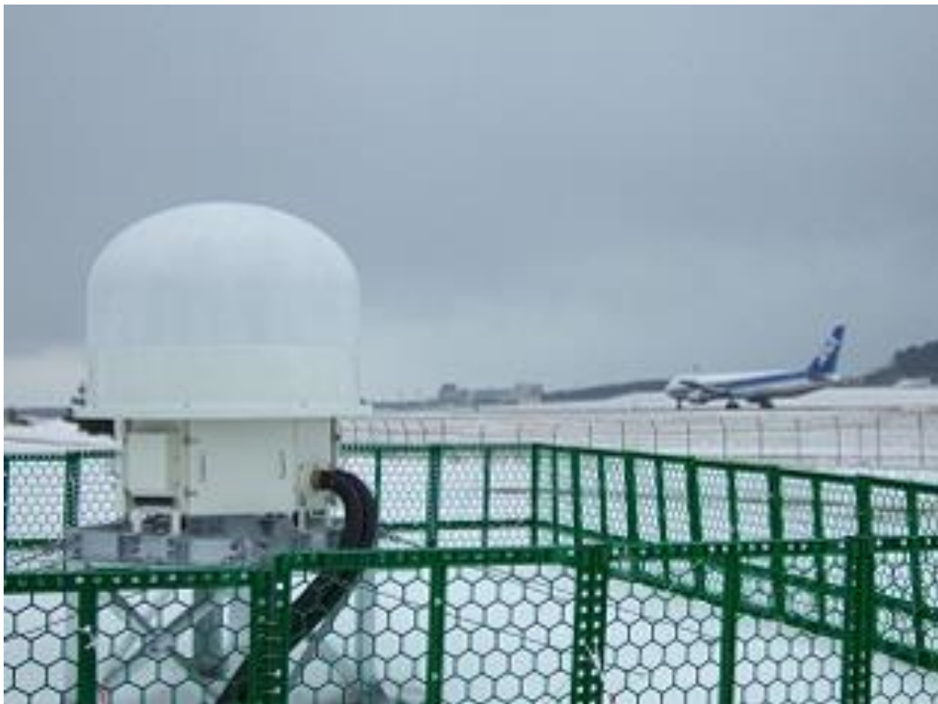
図 4.1 Ku 帯広帯域レーダの外観 (庄内空港滑走路横に設置)
