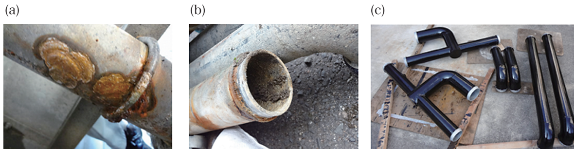
図2 冷却塔配管の腐食 (a) 交換前の錆, (b) 交換前の配管内部の錆, (c) 新品交換塗装品
