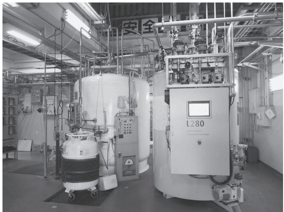
図8: 新しいヘリウム液化装置（手前）と既存の4000リットルの液体ヘリウム貯槽（奥）。
