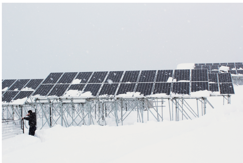
図 4 会津電力雄国太陽光発電所 (2017 年 1 月 16 日筆者撮影)
