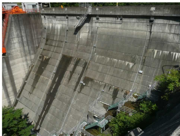
図-4.2.5 Aダムの堤体下流面漏水状況
