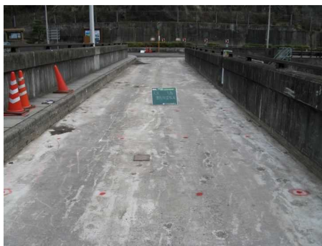
図-4.7.4 アスファルト舗装が撤去されたコンクリートダム堤体天端の状況
