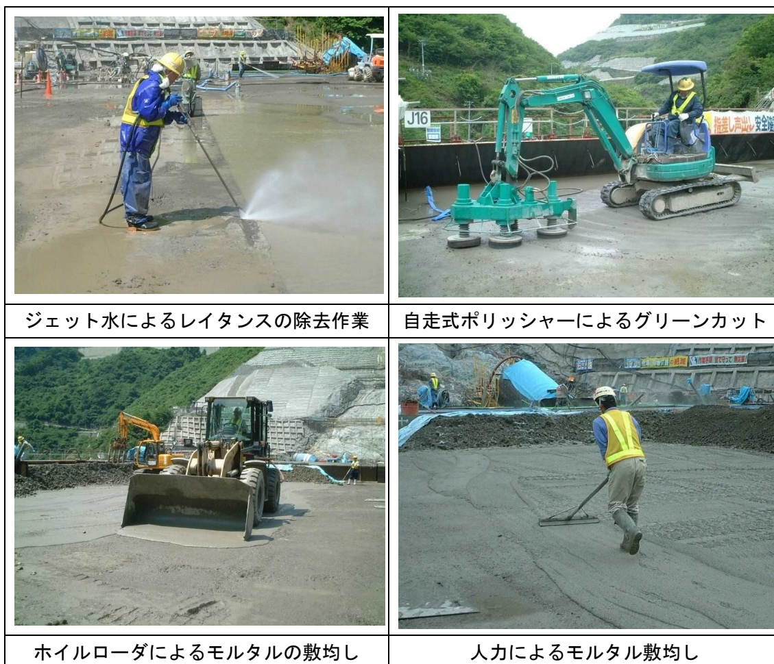
図-3.2.3 グリーンカット作業状況とモルタルの敷き込み状況 6)
