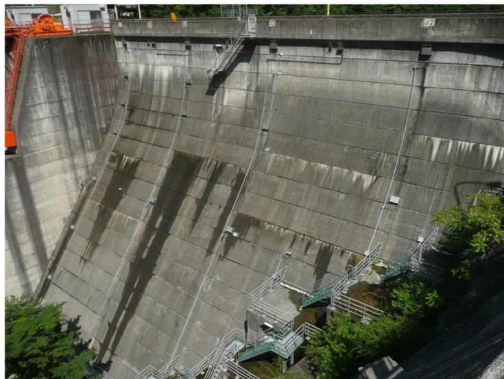
図-5.2.1 Aダムの漏水状況
