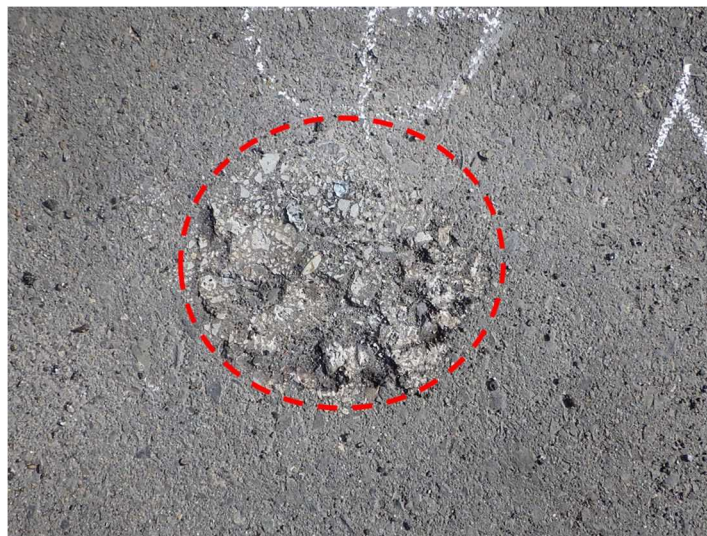
図-4.7.18 ハンマー打撃後のアスファルト舗装面
