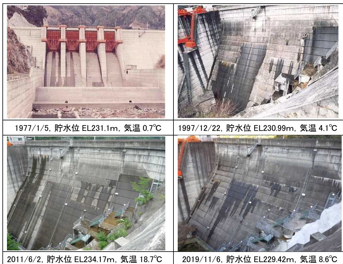
図-3.3.10 堤体下流面の漏水状況写真
