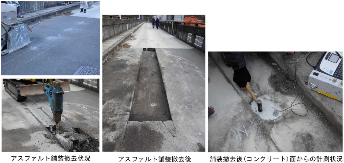
図-4.7.23 アスファルト舗装撤去状況と堤体コンクリート面からの計測状況
