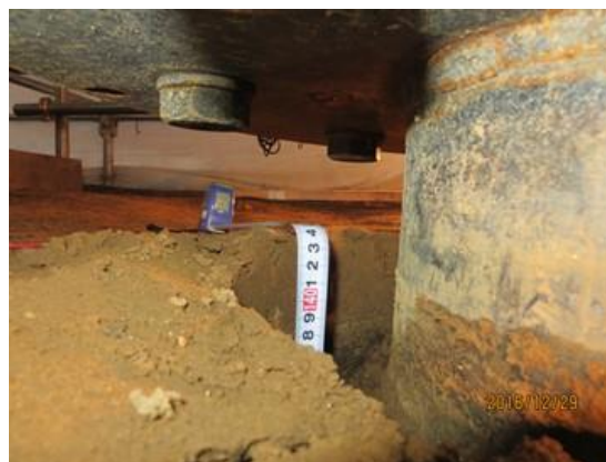
(ii) 剥離深さ ST 杭 (負加力の変位振幅 40mm 時)
