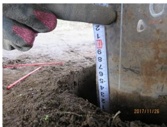
(ii) 剥離深さ W23A 杭 (正加力の変位振幅 40mm 時)
