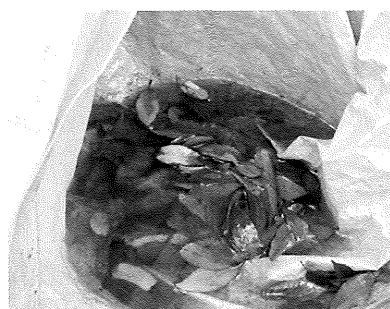
ブルーシートに溜まった水
