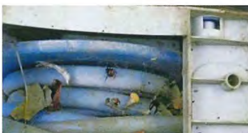
写真40. ホース巻き取り器 (左の写真拡大)
