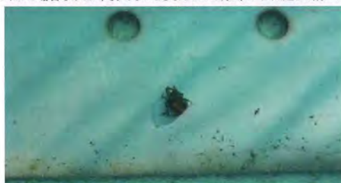
写真20. 使用前のプールの排水溝
