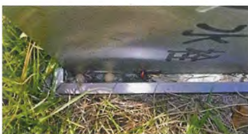
写真38. 散水栓 (左の写真拡大)
