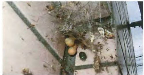
写真48. 窓枠の上方の右隅 (左の写真拡大)
