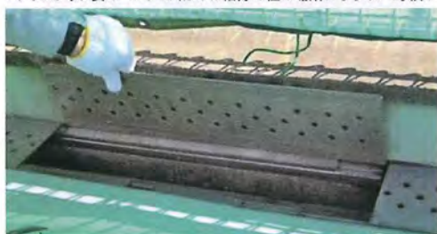
写真19. 使用前のプールの排水溝
