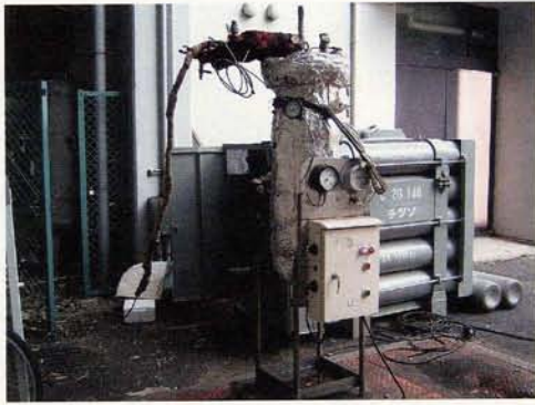
N 2 ガスとヒーター
