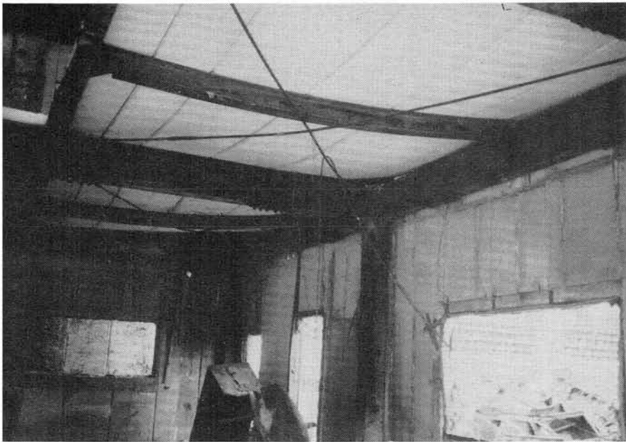
(S造建物内部の被害)
