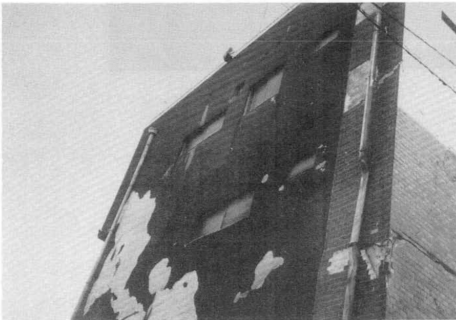
写真14 御蔵通5・6丁目地域南側 (RC造建築物の被害)
