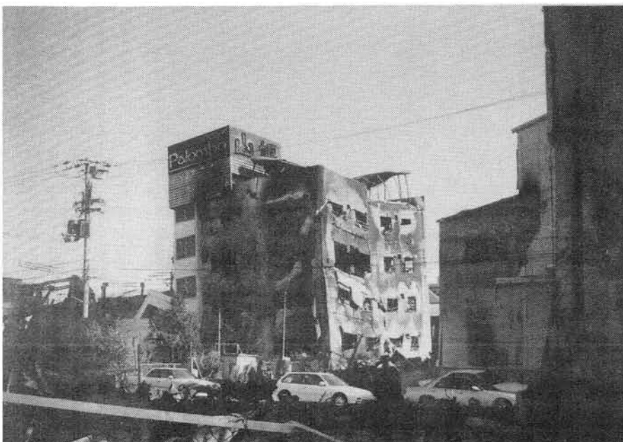
写真15 御蔵通5・6丁目地域南側 (RC造建築物の被害)
