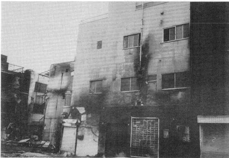
(S造建物の被害)
