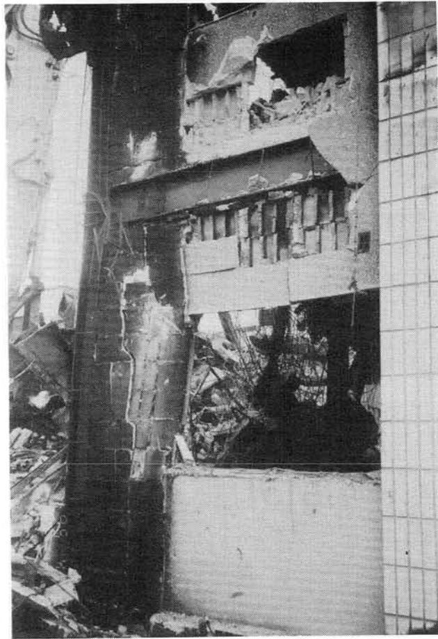
（S造建物コンクリート・ブロック壁の被害）
