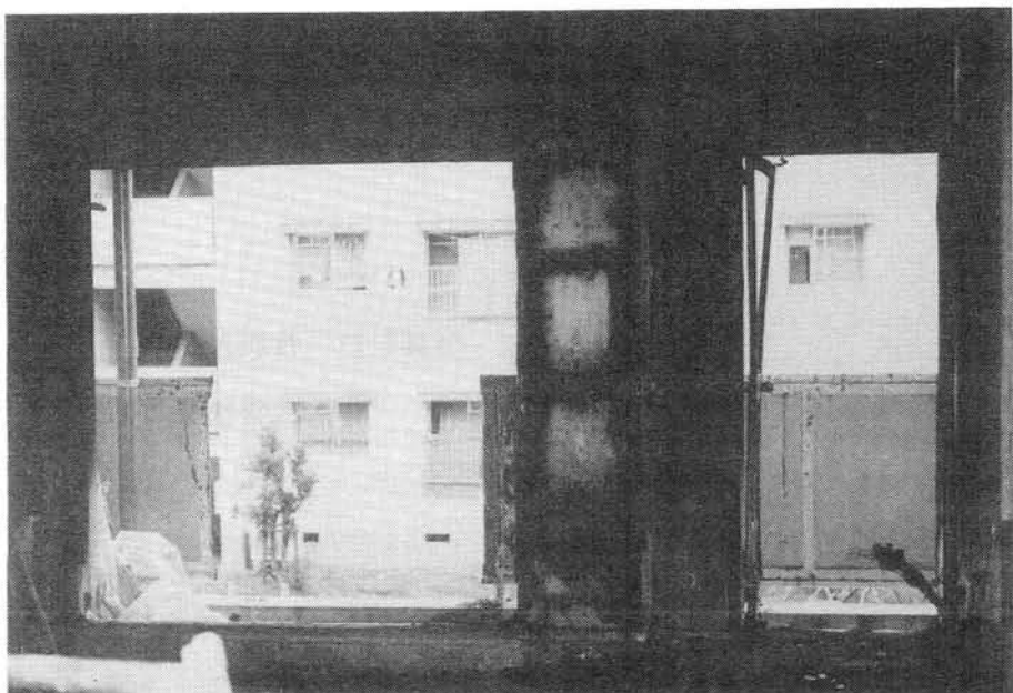
写真2.18 和室4.5帖及び 台所南面壁の火害状況
