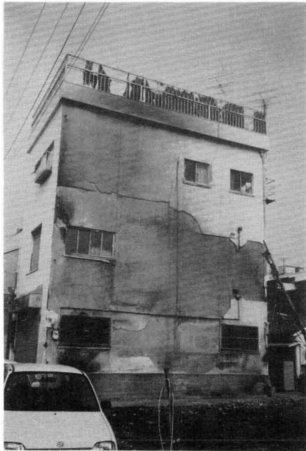
(RC造建物の被害)
