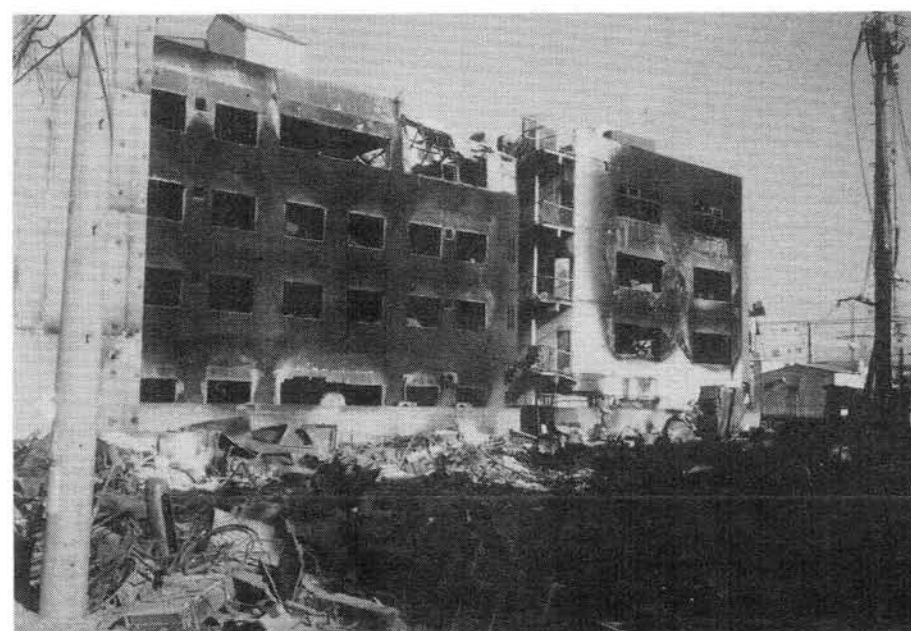
（RC造建物の被害）
