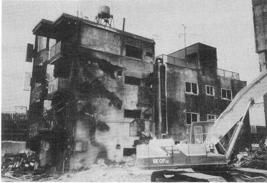
(コンクリートブロック製壁S造建物の被害)
