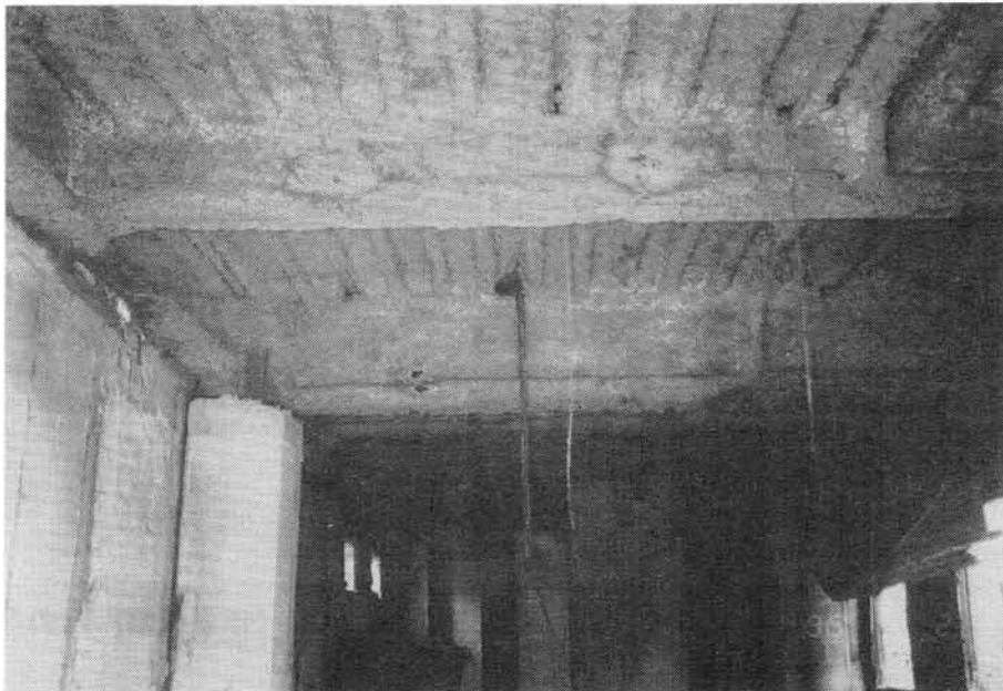
(S造建物内部の被害)
