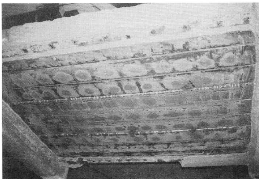
写真3.3 複合板（フラット・デッキ）の加熱後の状況
