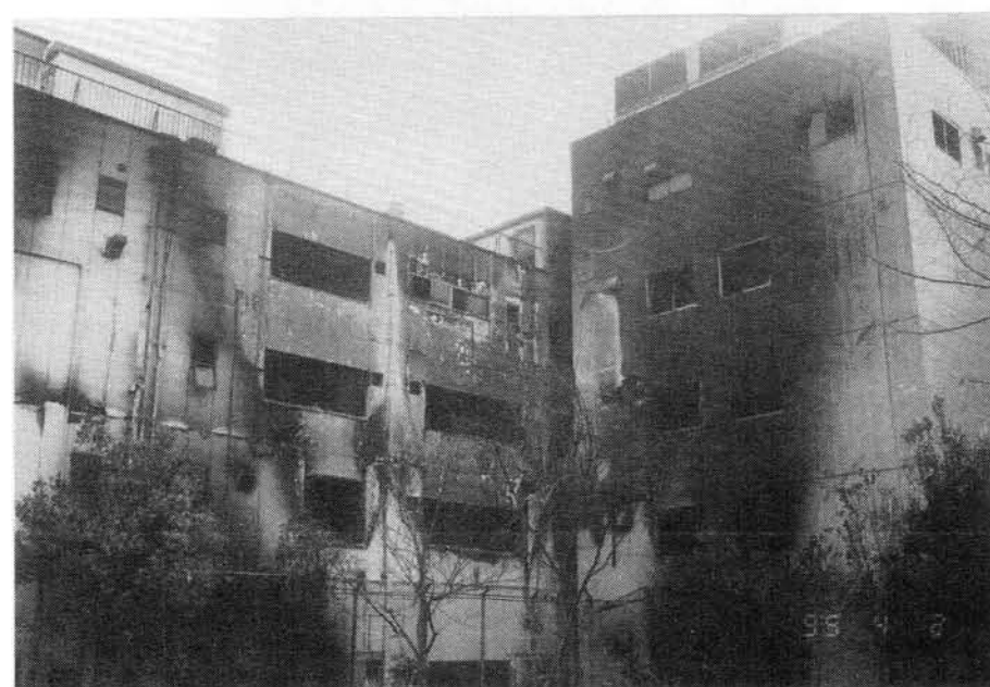
(S造建物とRC造建物の被害)
