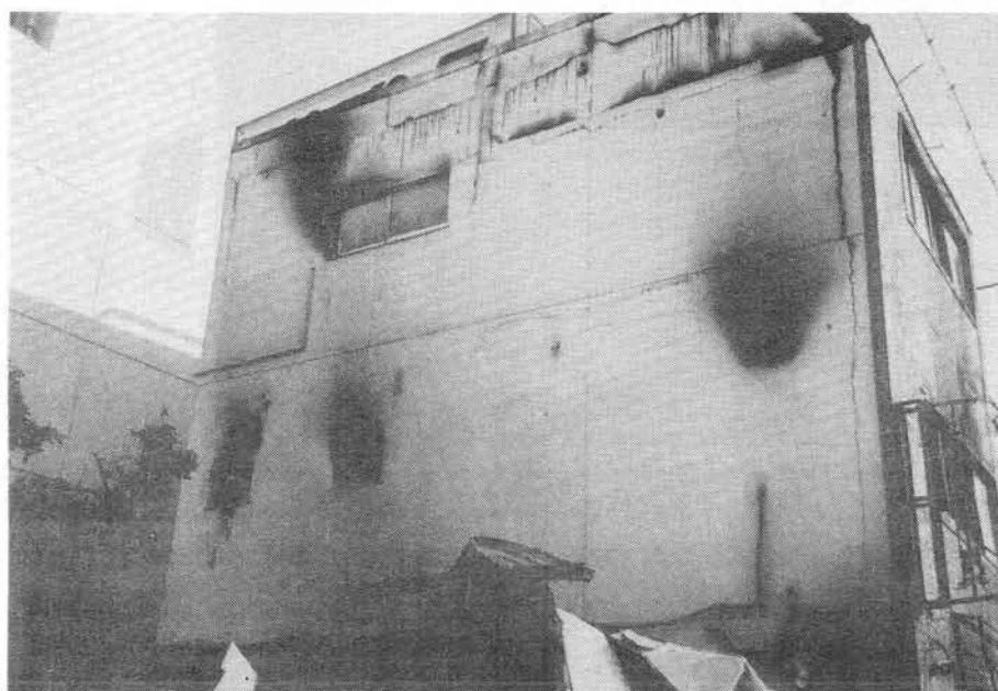
写真5 青木駅南地域（3階S造建物）
