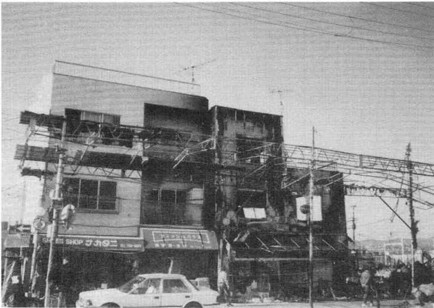
写真27 長田区高橋病院周辺地域 (RC造建物とS造建物の被害)
