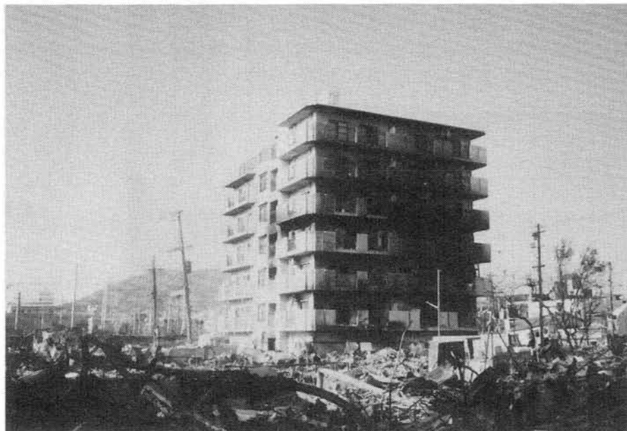
写真30 長田区高橋病院周辺地域（RC造建物の被害）
