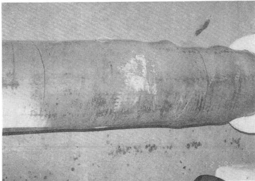
写真2.3 崩壊状況（円形CFT柱）
