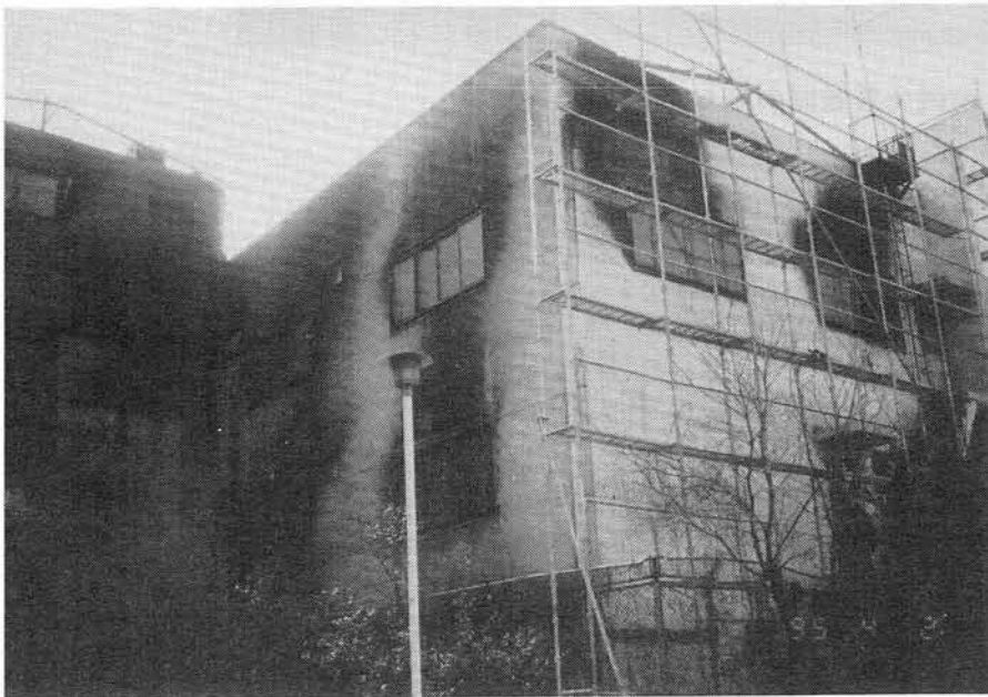
(南側公園周囲のRC造建物の被害)
