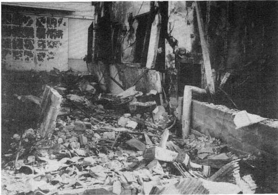
写真13 御蔵通5・6丁目地域 (S造建築物のALCの被害)
