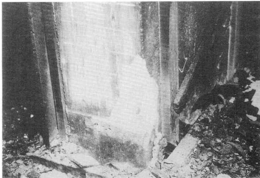
写真2.23 袖壁部分の火害状況（1）
