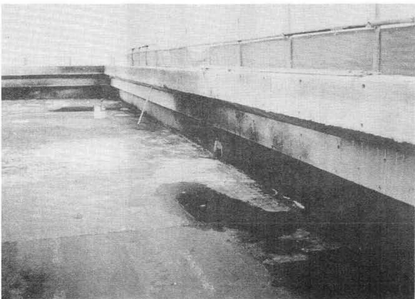
写真2.5 パラペット及び 屋上の火害状況（1）
