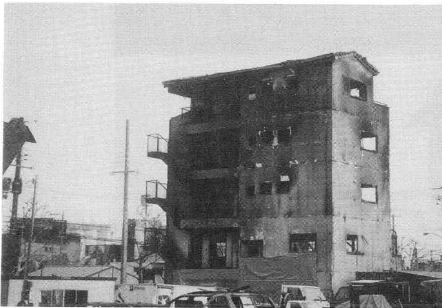
（S造建物の被害）
