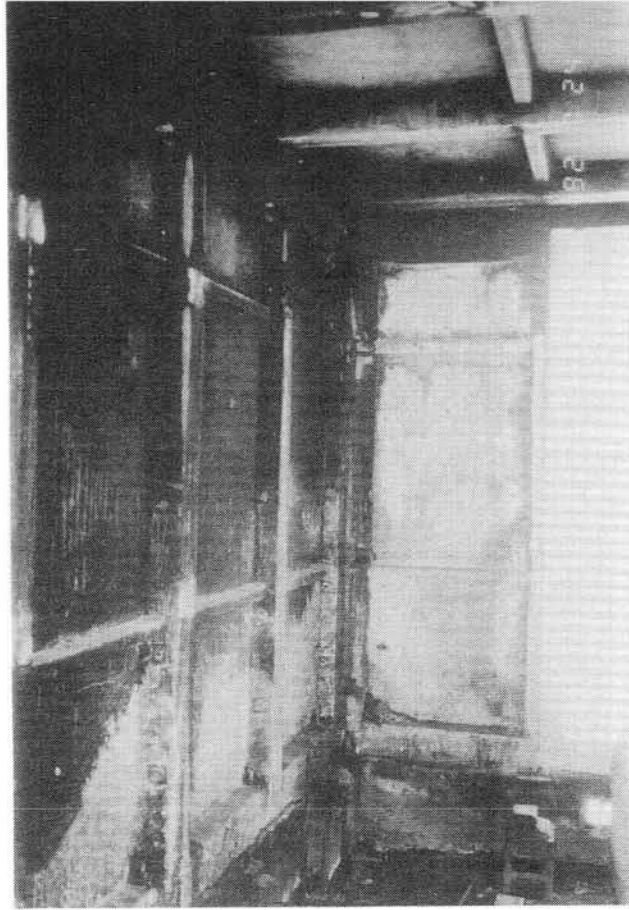
写真2.14 1階和室4帖の火害状況
