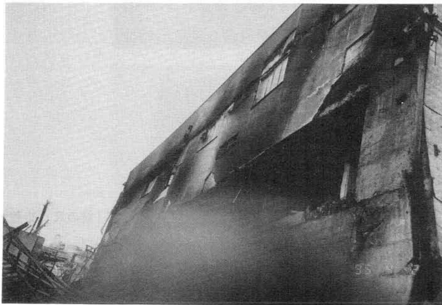
(RC造建物の被害)
