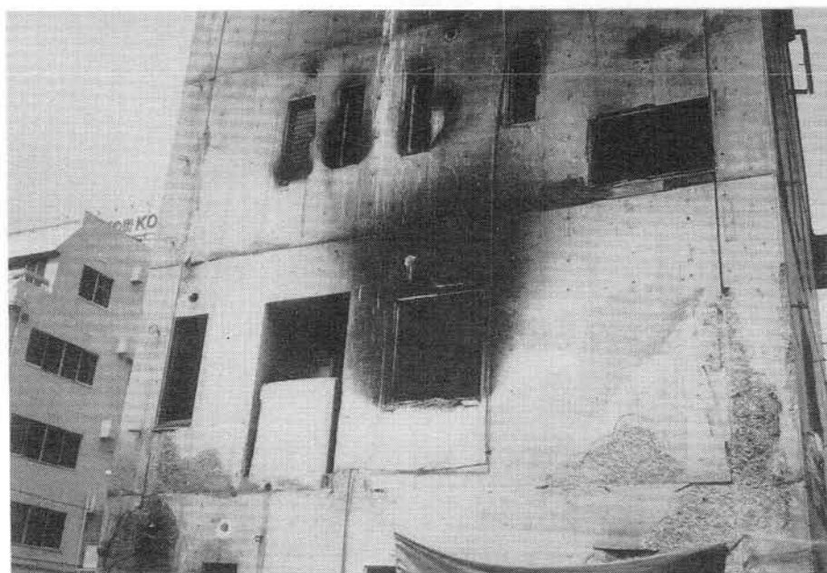
(R C 造建物の被害)
