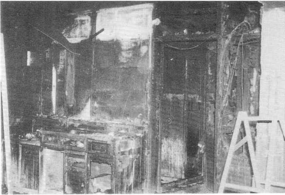
写真2.16 台所部分の火害状況
