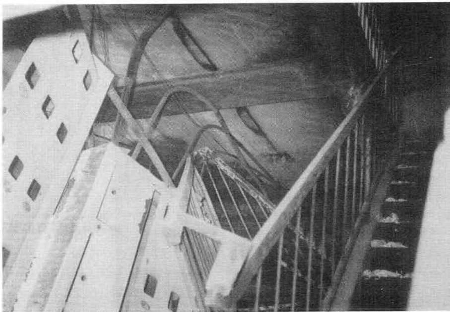
（S造建物の被害）
