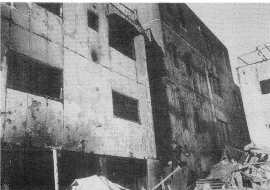
(S造建物とRC造建物の被害)
