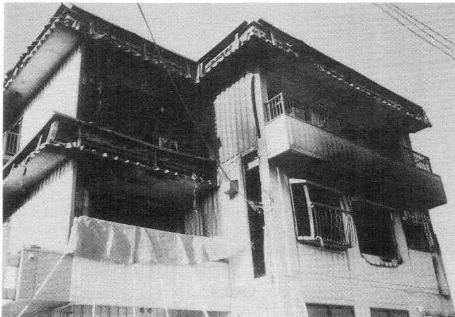
写真23 長田区高橋病院周辺地域 (S造建物のALCの被害)
