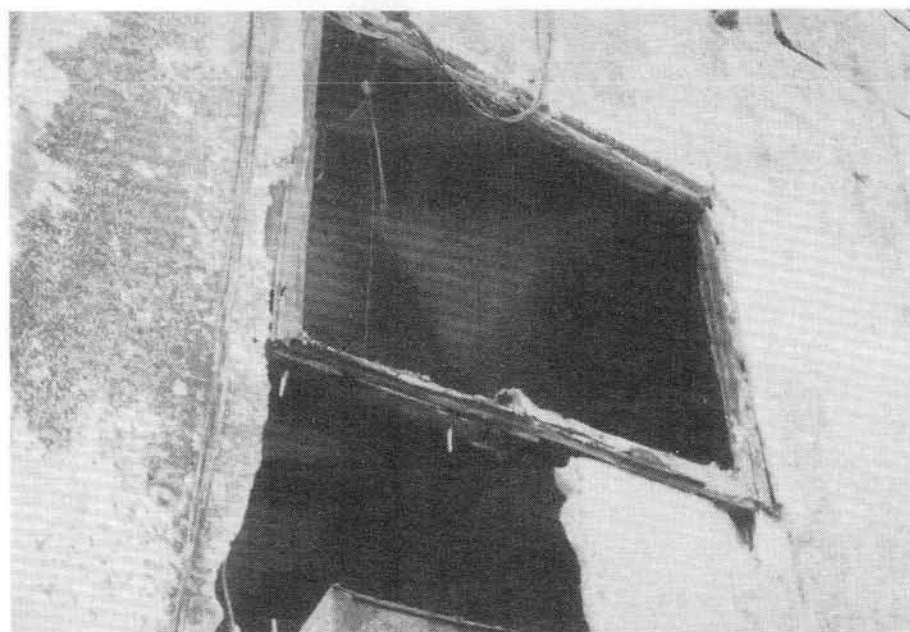
(S造建物の被害)
