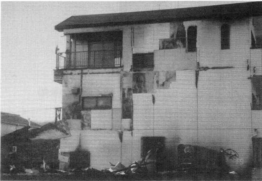
(RC造建物の被害)
