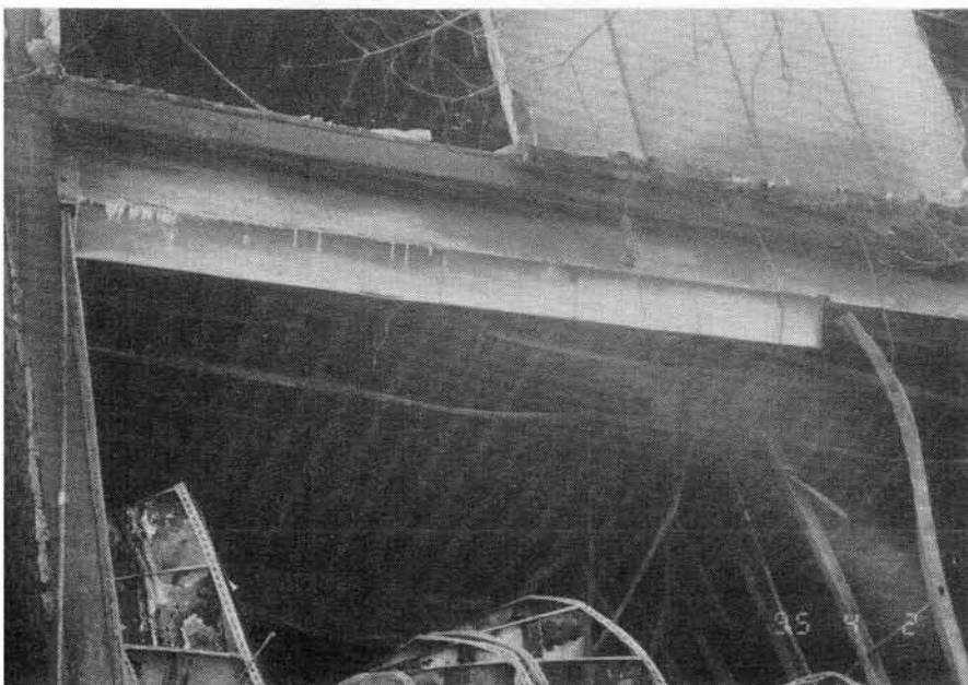
(南側公園周囲のS造建物の被害)
