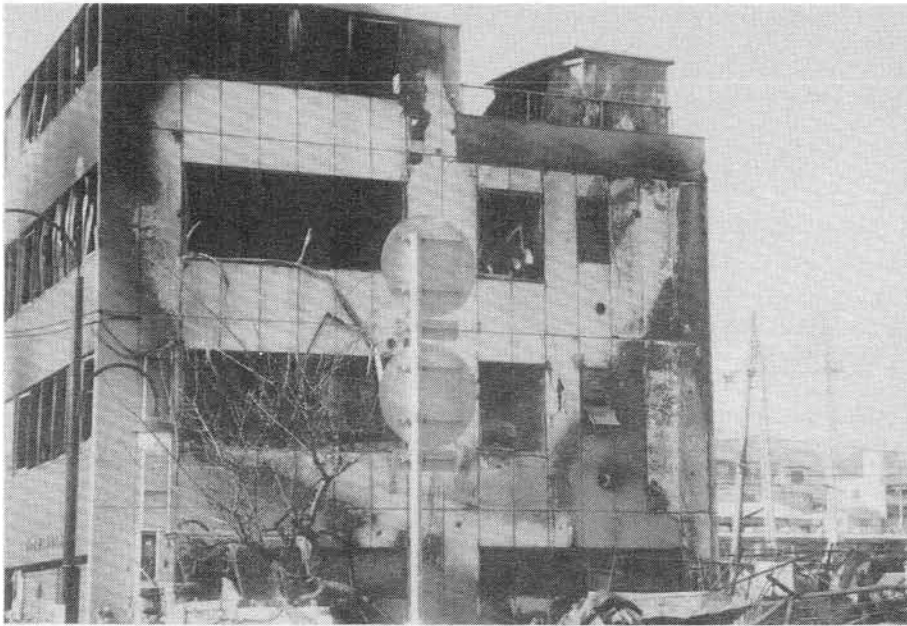
写真25 長田区高橋病院周辺地域 (S造建物の被害)
