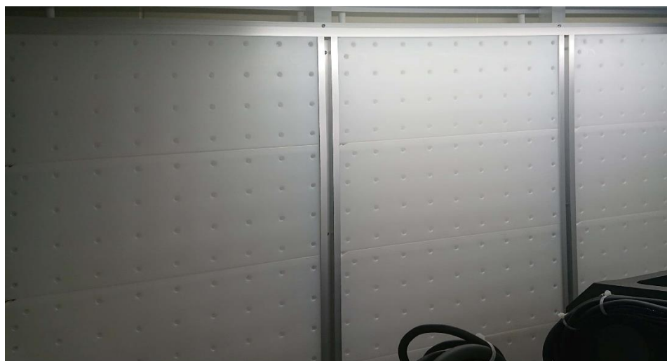
図 3.11 恒温室の水冷壁面
