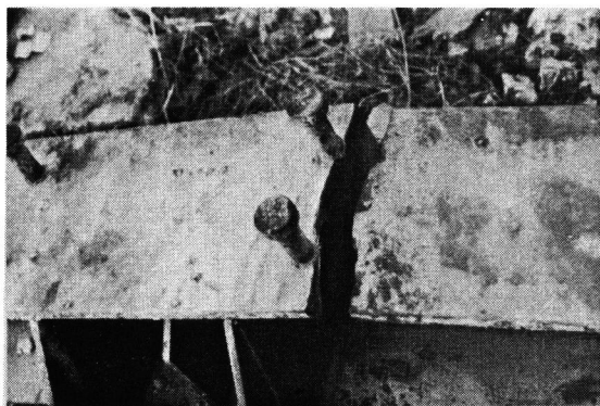
写真-2. 6 中間支点近傍の上フランジの疲労破断
