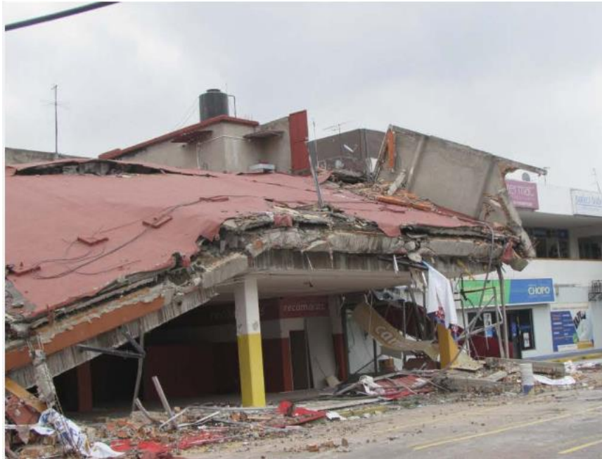
Photo1. 2. 2 商業ビル（フラットプレート構造）のパンチング破壊 4)
