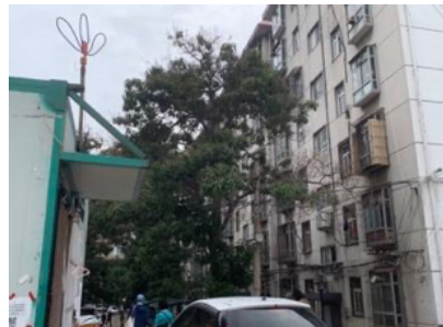
図6 コミュニティ Bの内部-錯綜した電線
