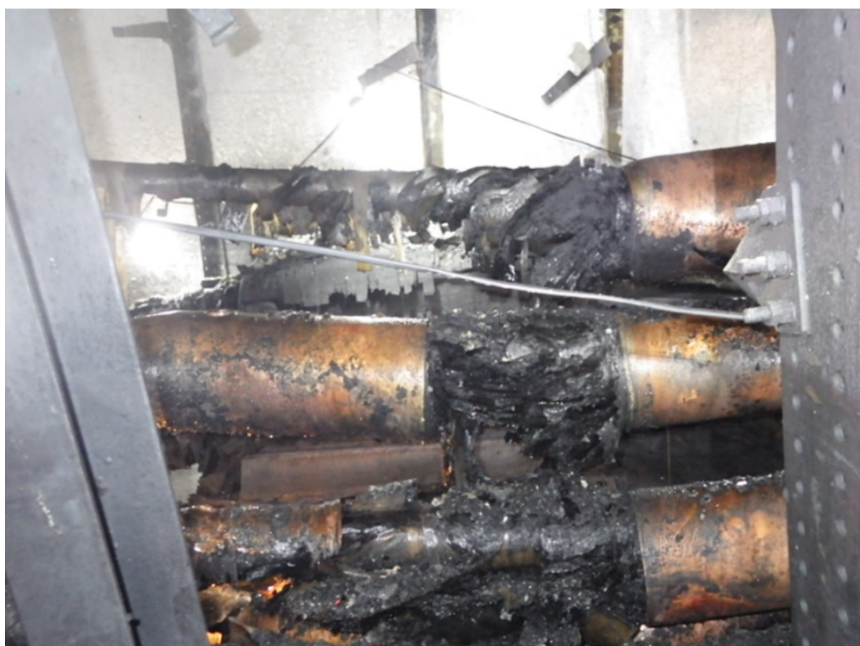
図 1.1 絶縁破壊した実際の接続部の写真 「出典：東京電力ホールディングス」
